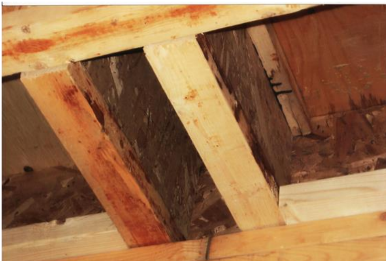
Absence de solive de bordure et charpente inadéquate.
